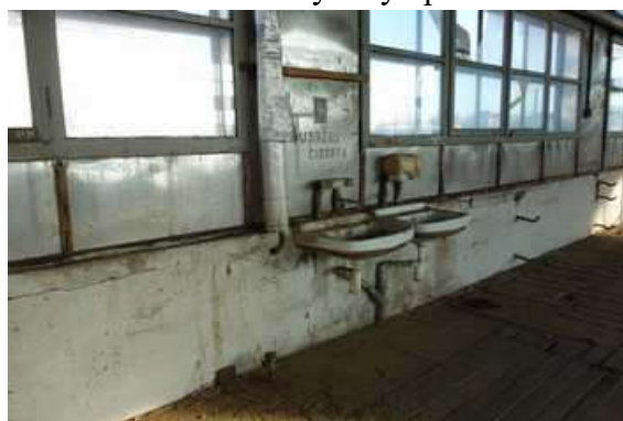
Nefunkční umyvadla na stěně
